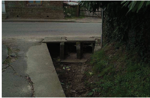
Photo 20 : Buse de collecte des ruissellements proche de l'église à Crasville
