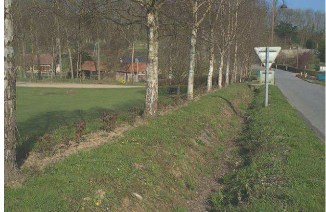
Photo 9 : Remblai le long de la RD 4 à la Gaillarde
